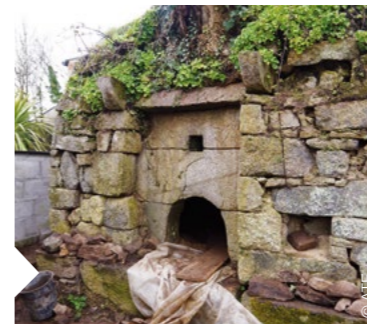
Il a fallu trois jours aux stagiaires pour défricher le dôme du four à pain, recouvert d'arbres.
